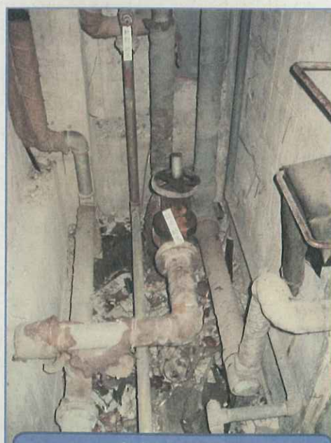
老朽化状況 本館地下1階パイプシャフト
